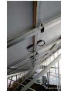
Photo 4 – Câblage sous les modules
