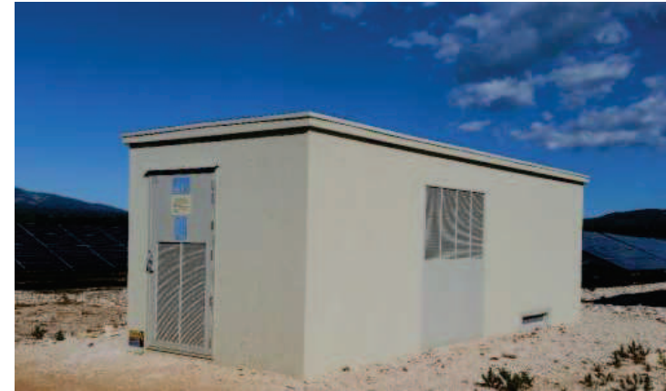
Photo 2 : Exemple de poste de transformation
