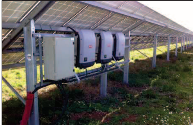
Figure 7. Exemple d'onduleurs strings fixés à l'arrière des tables de modules
